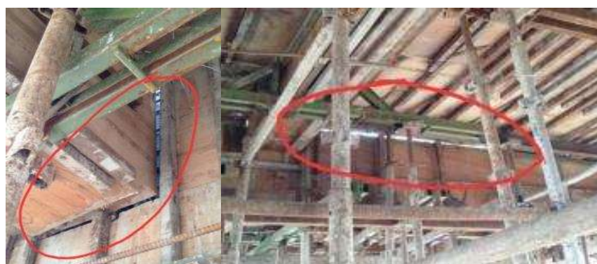
Gambar 5. Terdapat celah antar sambungan bekisting
