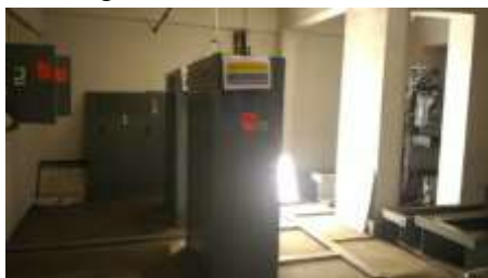
Gambar 2. Ruang Mesin Elevator
