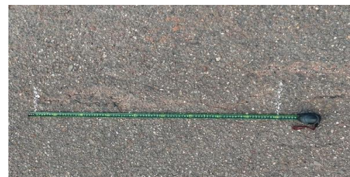
(b) Pengukuran panjang/lebar kerusakan menggunakan meteran
