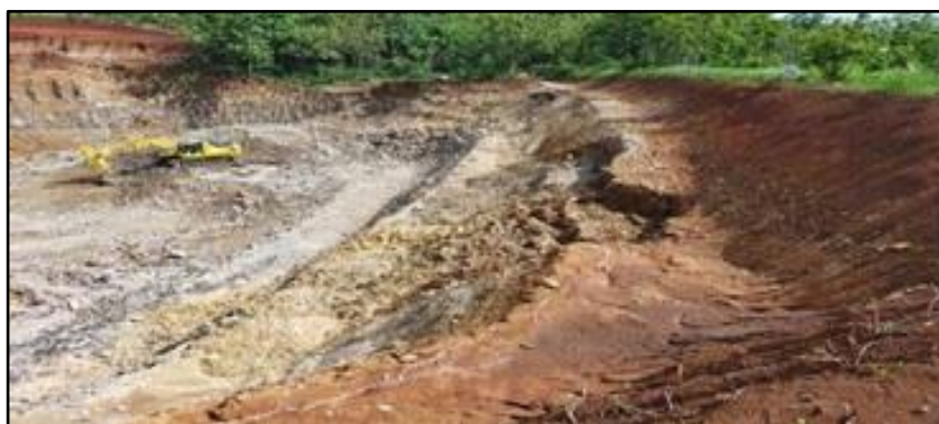
Gambar 1. Kelongsoran lereng bagian atas spillway
