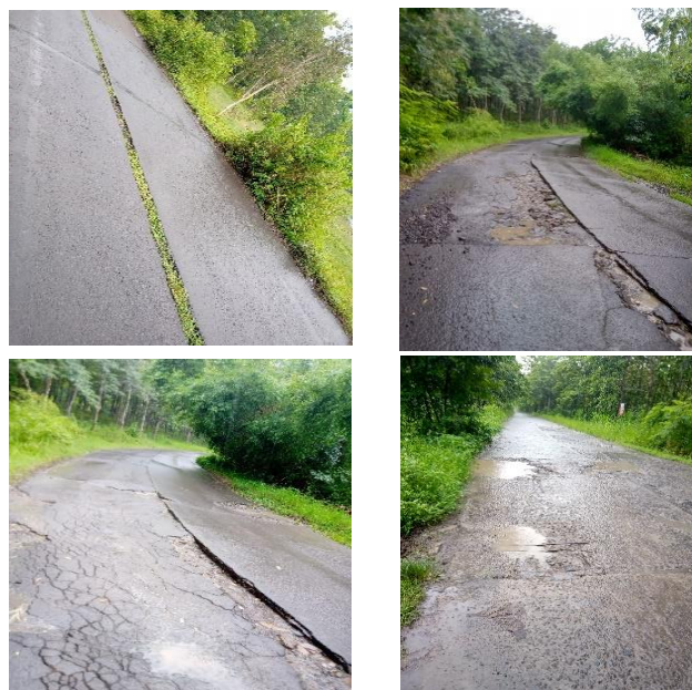
Gambar 1. Kerusakan jalan pada Jalan Karanggede – Juwangi
