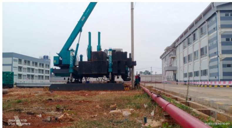
Gambar 4. Pekerjaan Pemancangan alat HSPD Proyek PT. Formosa Mayong Jepara (PT. Paton Buana Semesta Semarang, 2022)
