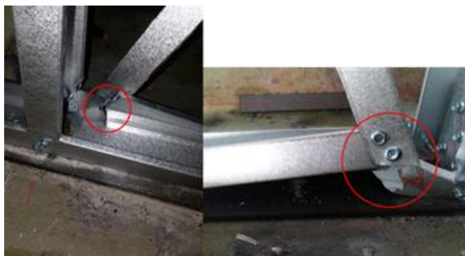
(d) robek pada sayap dan badan profil (e) robek pada sayap dan badan profil Gambar 8. Kerusakan yang terjadi pada panel PC75-S-E-01
