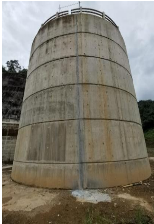
Gambar 5. Foto retak rambut pada dinding pelimpah bendungan Tapin (BWS Kalimantan III, 2021)
