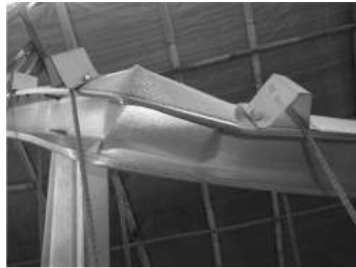
b. Kegagalan tekuk lokal pada batang tekan
