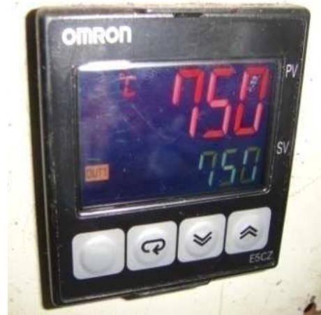
Gambar 11. Pengaturan temperatur pada dapur pemanas
