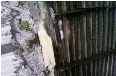
Gambar 5. Heater sebelum diganti
