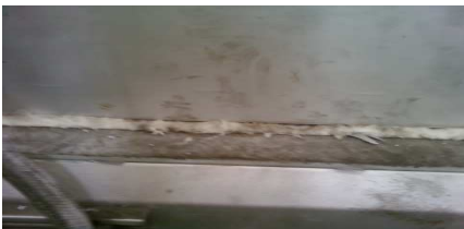
Gambar 10. Blanket sebelum diganti
