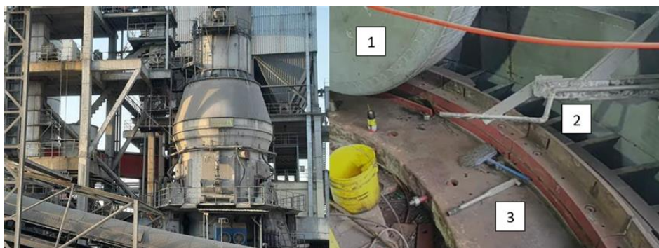
Gambar 1. Vertical Roller Mill (kiri) dan sistem water injection di dalamnya (kanan)
