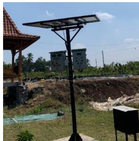
Gambar 7. Panel Kendali dan Panel Surya
