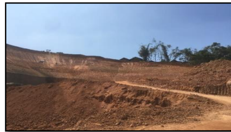
Gambar 5. Kondisi Eksisting Bagian Atas Lokasi Pekerjaan yang Berpotensi Longsor
