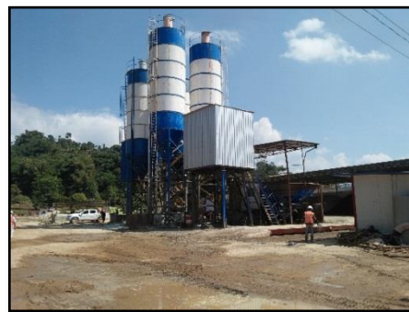
Gambar 1. Kondisi Eksisting Batching Plant
