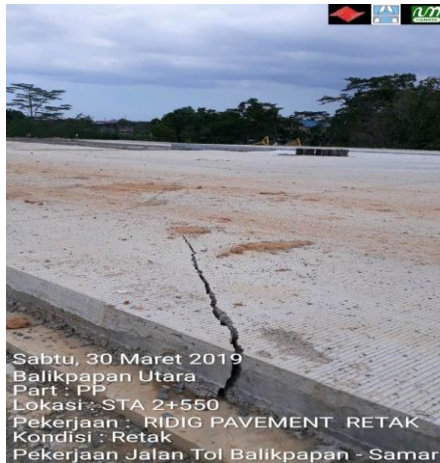
Gambar 4.1 Retak di tepi ( corner breaks ) pada rigid pavement Sta.2+550
