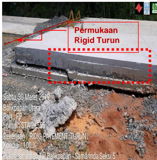
Gambar 4.6. Permukaan rigid turun pada rigid pavement Sta.2+555
