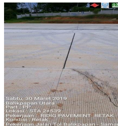
Gambar 4.5. Retak pojok ( corner breaks ) pada Rigid Pavement Sta.2+539
