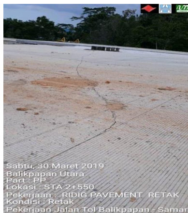
Gambar 4.4. Retak join ( joint damage ) pada rigid pavement Sta.2+550
