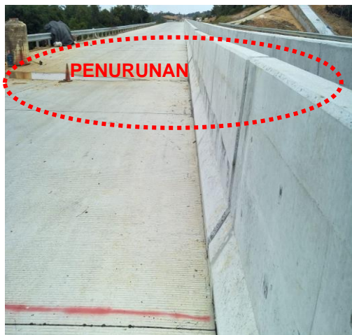
Gambar 4.8. Penurunan rigid pavement pada Sta.1+335
