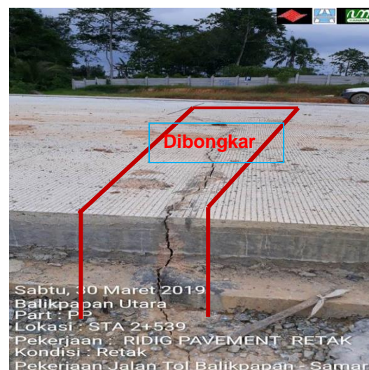
Gambar 4.7. Retak Melintang pada rigid pavement pada Sta.2+539
