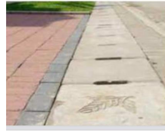
Gambar 16: Drainase Segi Empat Pasangan Batu Kali Tertutup
