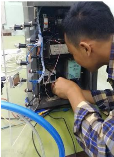
Gambar 3.4. Panel Hubung Bagi Plant
