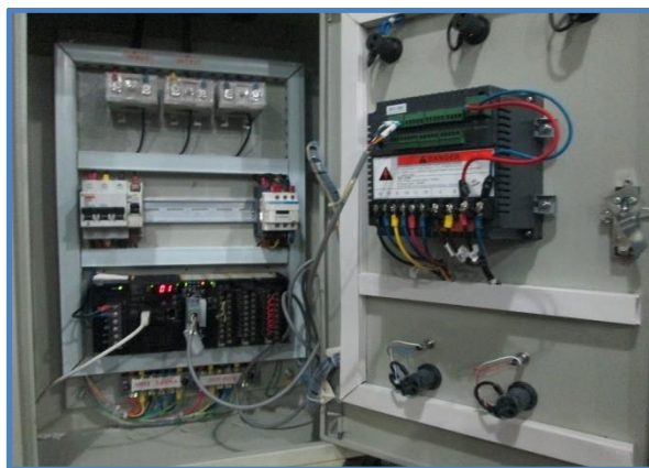
Gambar 8 Panel Kontrol Bagian Dalam
