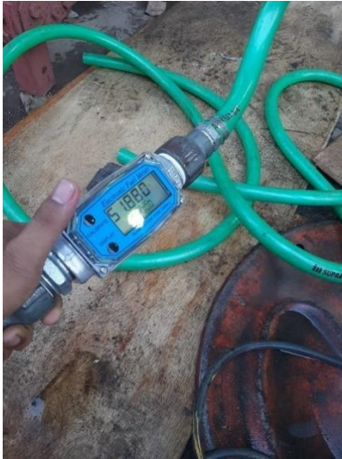
Gambar 7. Debit pada instalasi sebelum mengalami kebocoran
