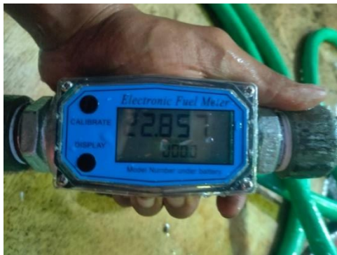
Gambar 8. Debit pada instalasi setelah mengalami kebocoran
