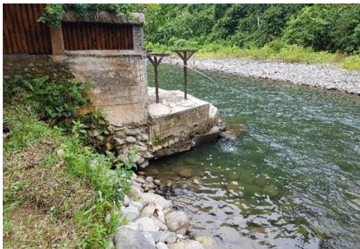
Gambar 7. Lokasi potensi kerusakan bangunan akibat gerusan.
