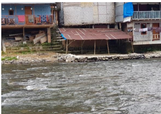
Gambar 10. Lokasi potensi kerusakan bangunan akibat gerusan.
