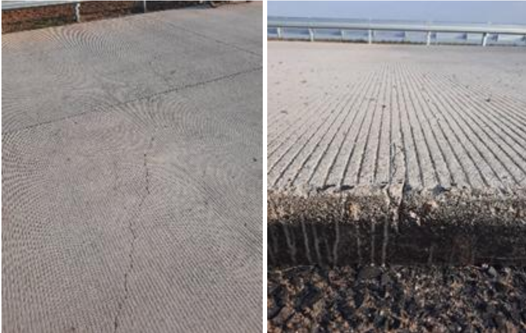
Gambar 4. Keretakan rigid pavement pada Sta 18+375
