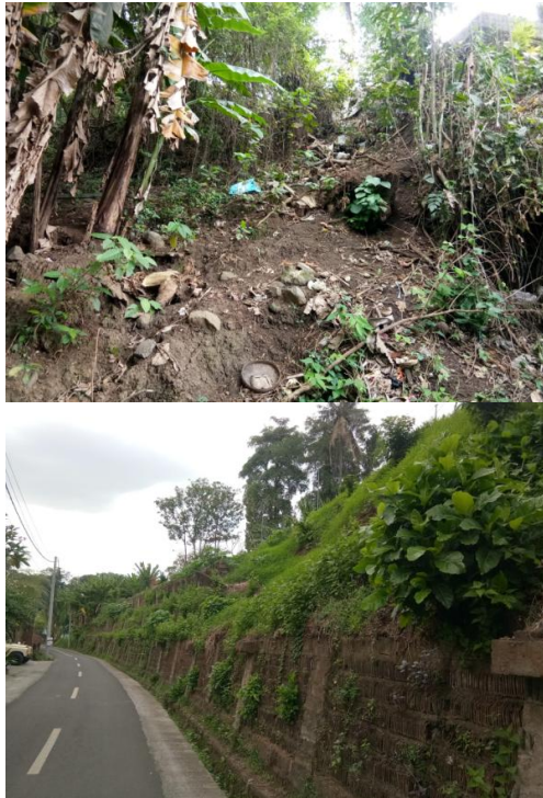
Gambar 2. Kondisi Eksisting Setra Tunon
