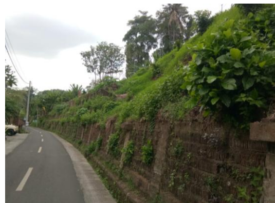
Gambar 2. Kondisi sisi Utara Setra Tunon
