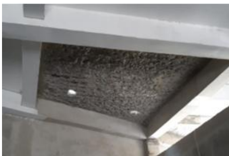
Gambar 6. Kondisi pelat yang mengalami bunting
