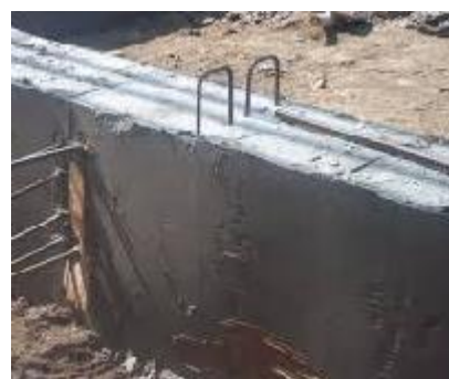
Gambar 4. Kerusakan bunting pada penampang beton
