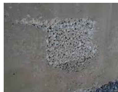
Gambar 2. Gambar void pada beton
