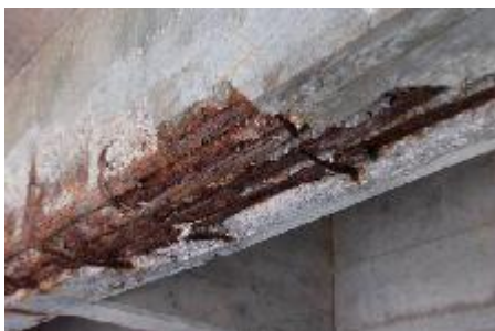
Gambar 3. Kerusakan Scaling pada penampang beton.
