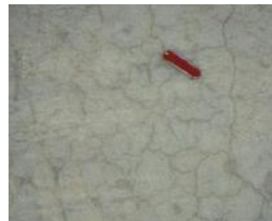
Gambar 1. Gambar kerusakan crack penampang beton.
