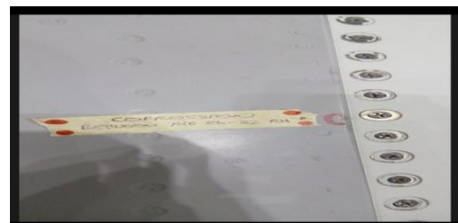
Gambar 7. Posisi Korosi berada pada antara Rib 26 – Rib 27
