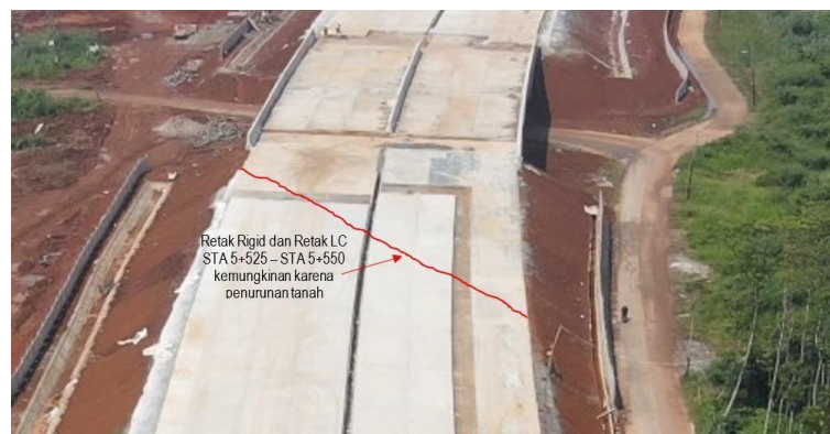
Gambar 5. Retak pada perkerasan kaku dan Lean concrete pada STA 5+525-5+550
