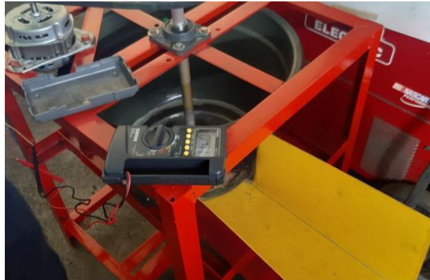
Gambar 10. Pengujian Sistem Generator Listrik
