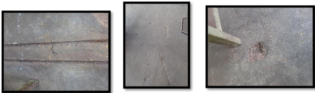
Gambar 5. Kerusakan pada Lantai
