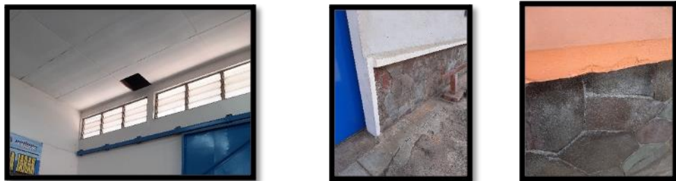
Gambar 3. Kerusakan pada Plafond dan Dinding
