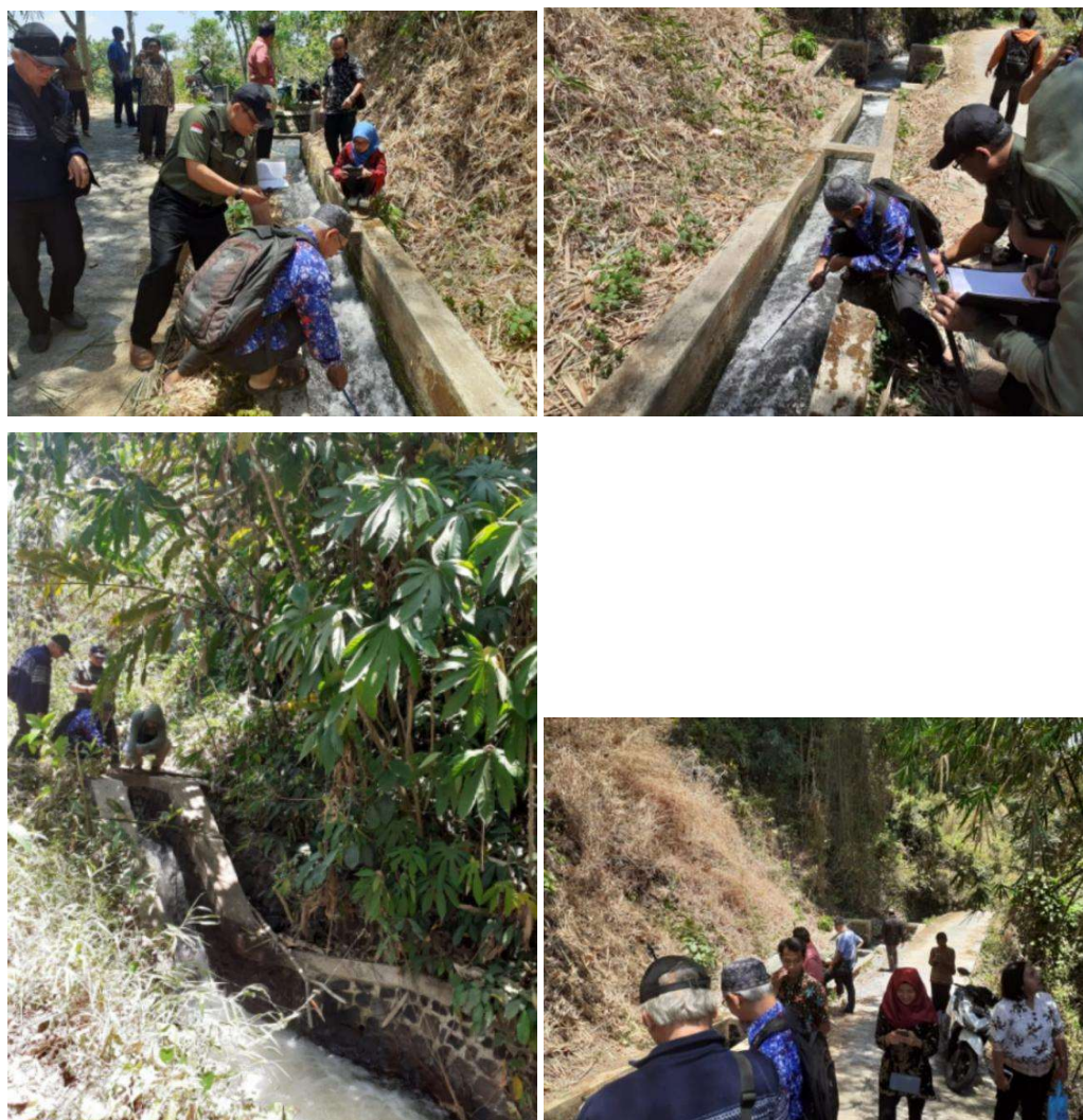
Gambar 7. Survei lapangan dan pengukuran potensi di saluran aliran air
